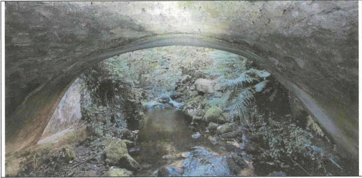
Zoom sur des décollements de rejointoyements de la voute
