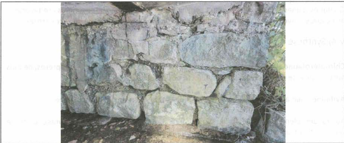
Zoom sur les disjointements de la culée nord
